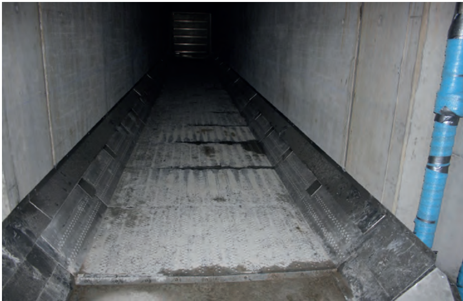
Wärmetauscher im Zulaufkanal
